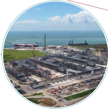
Corpus Christi LNG Terminal ~15 mtpa Total Production Capacity
