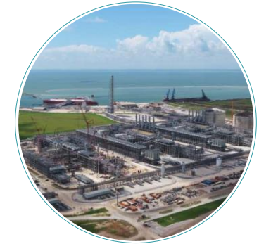
Corpus Christi LNG Terminal ~15 mtpa Total Production Capacity
